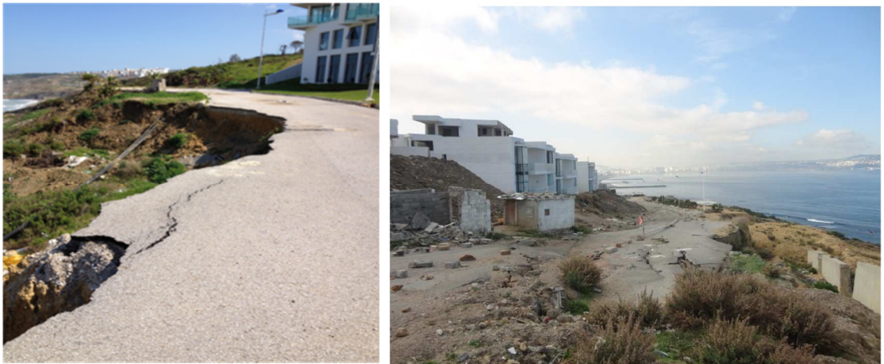
Figure 3: Photographies de quelques désordres suite au glissement de terrain
