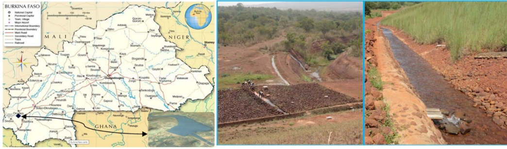
Figure 1 Localisation du barrage et de la retenue (Vue satellite) →, pied aval de la rive gauche à infiltration avec affaissement local (au milieu). Partie du flux d'infiltration (à droite).
