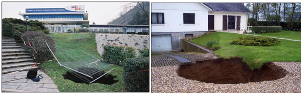
Figure 2. Exemples d'effondrements localisés au droit de cavités d'origine anthropique (à gauche le cas d'une mine de charbon à droite celui d'une carrière– Source : Ineris
