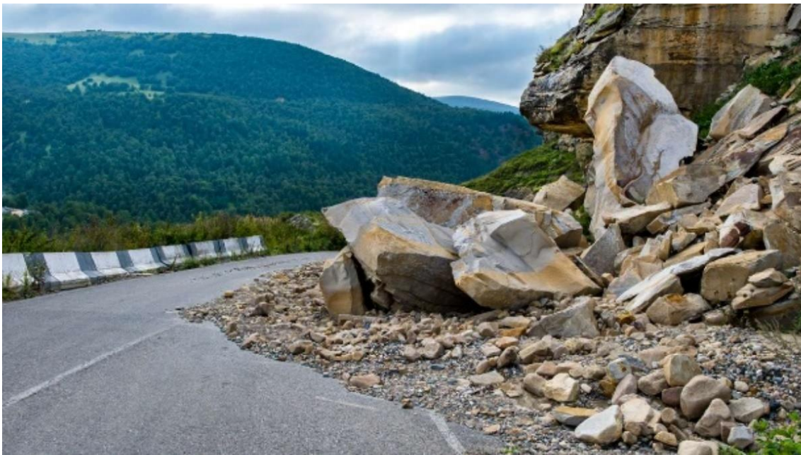
Figure 1. Illustration d'une chute de blocs rocheux sur un tronçon routier, (Cerema 2020).
