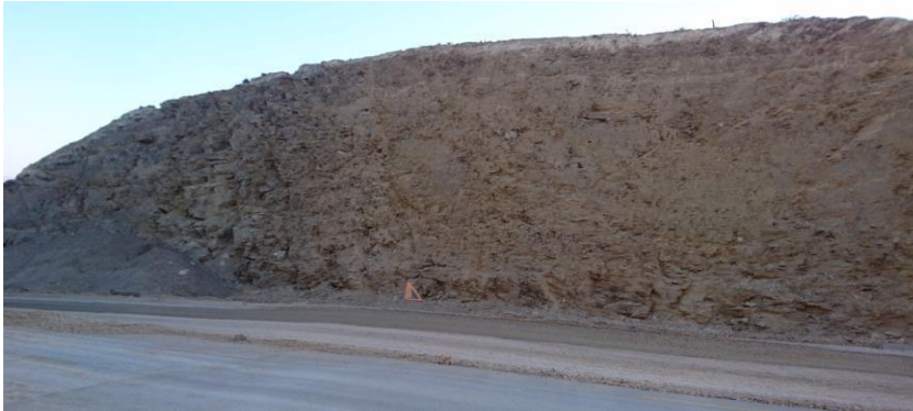
Photo 2. Terrains marno-schisteux altérés et évolutifs sur le déblai D7 Section 1
