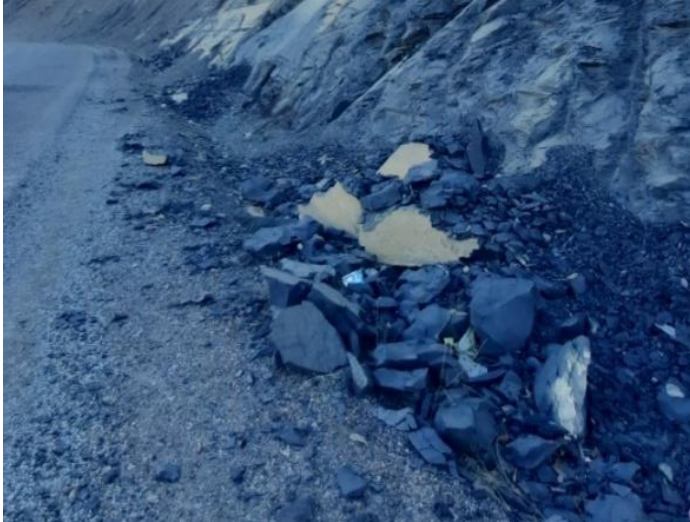
Figure 10. Débris marno-schisteux sur le bas-côté de la route, (2023).
