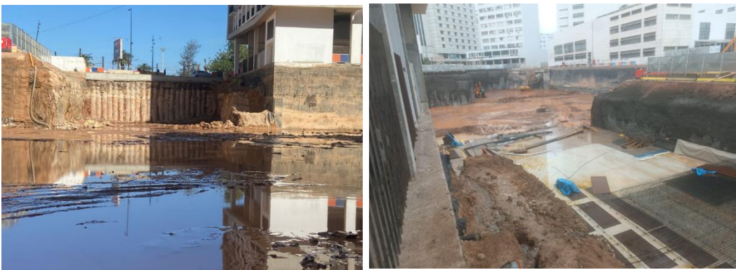
Figure 5 : photo de la fouille du projet Parking du Triangle des hôtels à Casablanca
