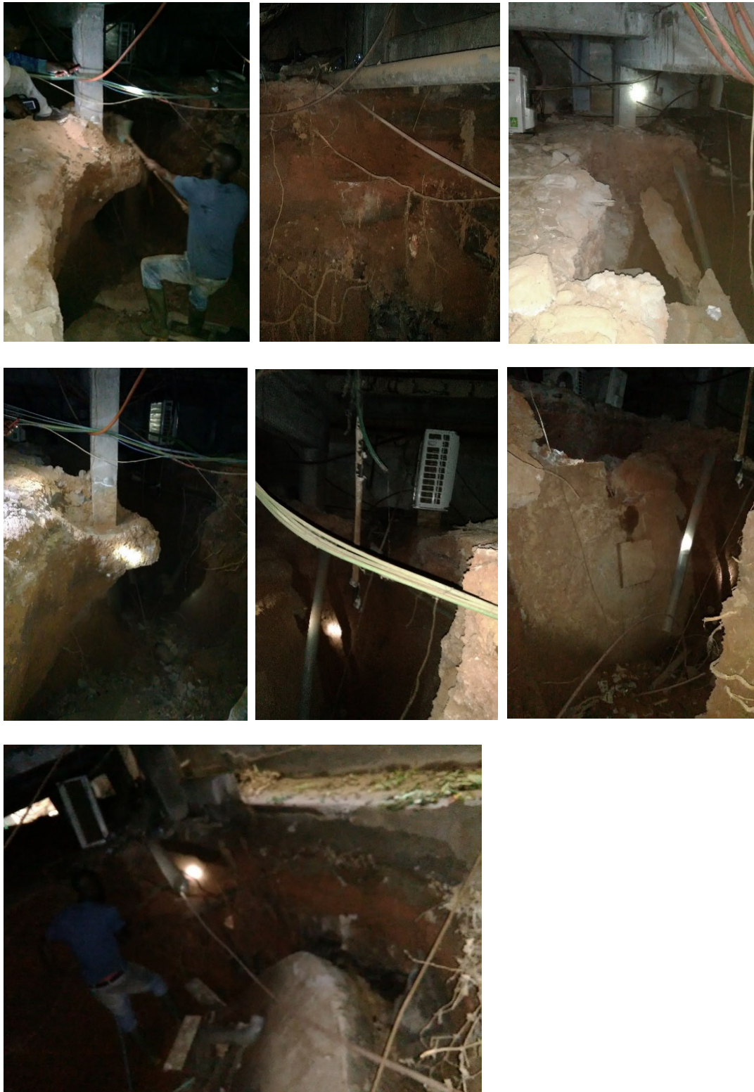
Figure 11 : Effondrement du sol de fondation (fontis)
