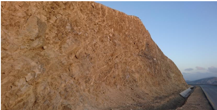
Photo 3. Terrains marno-schisteux altérés et évolutifs sur le déblai D7 Section 2
