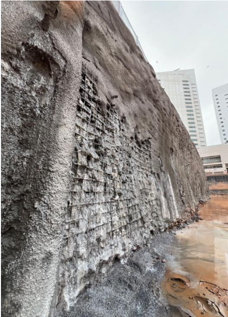
Figure 6 : Délavage du béton projeté à cause des fortes venues d'eaux dans le parement
