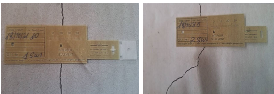
Figure 5 : Suivi des fissures avec les jauges de type G1
