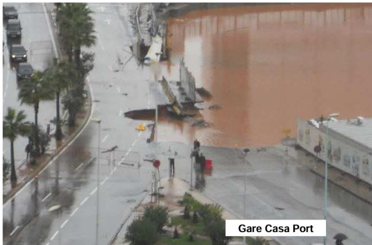
Figure 1 : photo de l'effondrement de la fouille de la gare Casa Port en Novembre 2010
