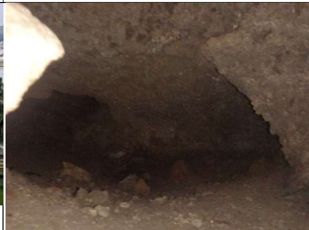
Fontis avec cloche mis à jour au niveau des caves voutées
