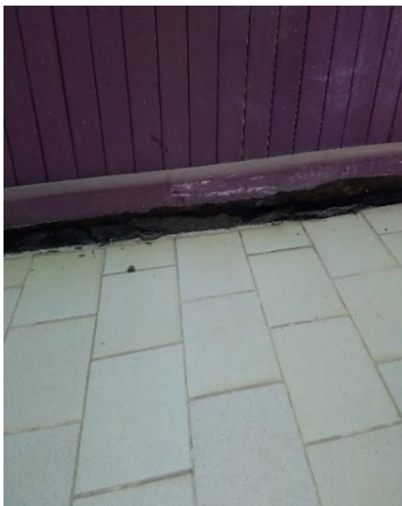
Figure 3 : affaissement du plancher bas RDC
