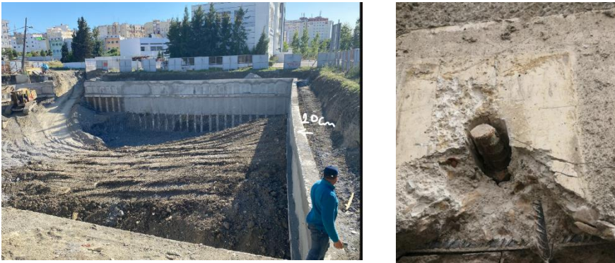
Figure 13 : photo des désordres de la fouille de la clinique
