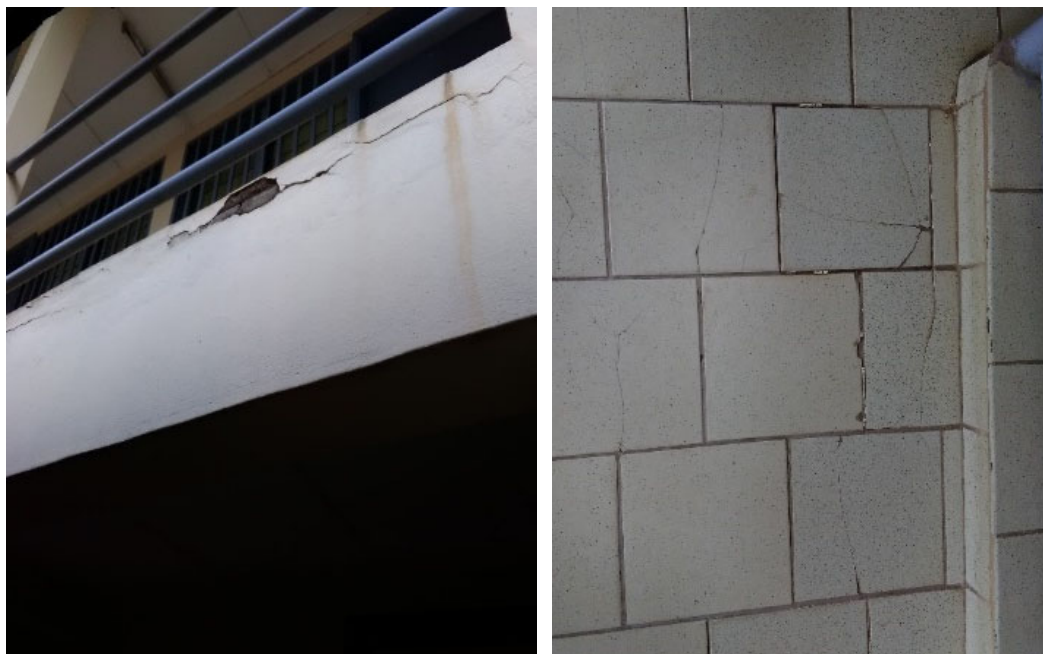
Figure 2 : Apparition des fissures sur les éléments de structure du bâtiment
