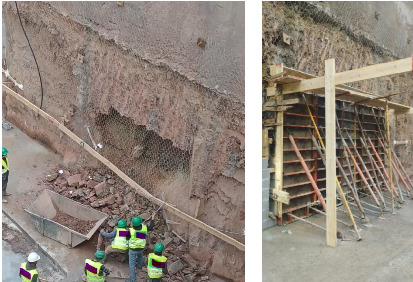
Figure 4 : photo de l'effondrement du parement rocheux
